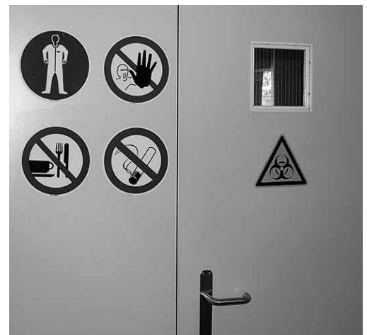
Bild 4: Mit geeigneten Sicherheitszeichen ist auf die Gefährdungen im Arbeitsbereich, die Zutrittsbeschränkung, das Tragen von Schutzkleidung und das Ess-, Trink- sowie Rauchverbot aufmerksam zu machen.
