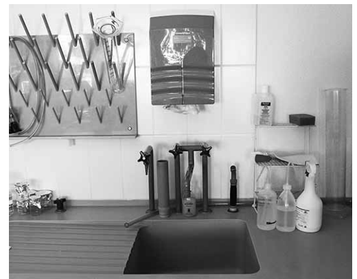
Bild 2: Handwaschanlage mit Wasch- sowie Desinfektionsmitteln und Einweghandtüchern.
